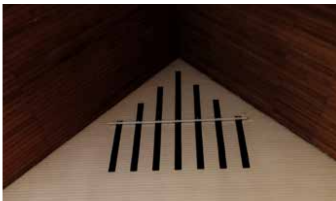
Udvendigt fremstår røgventilationens spalteluger i malet træfiberplade, med slidte overflader. Indvendigt med mørke spalter med vandret en stang med beslag til hver luge.
