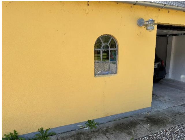
02 – Facader på garage udbedres for afskalninger
