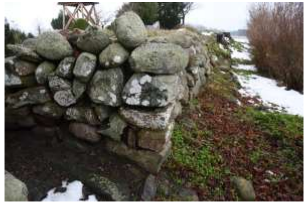
Foto 3. Ved den østlige kirkegårdsindgang hælder digehjørnet udad
