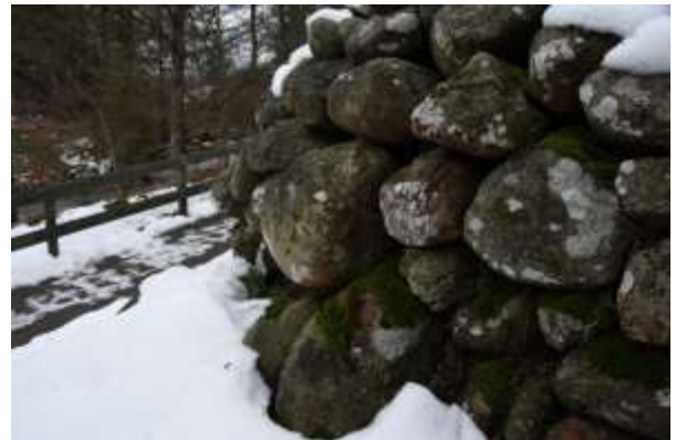
Foto 9. Det sydvestlige digehjørne er ustabil, men ikke udskredet
