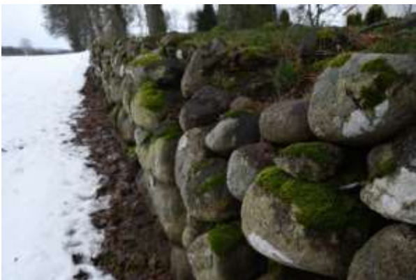
Foto 2. Østdigets vestlige del med løse sten
