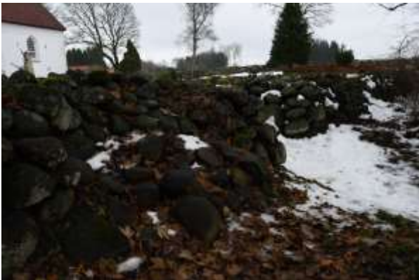
Foto 8. Udskredet parti på syddiget
