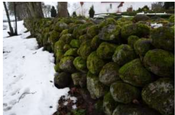
Foto 3. Østdigets vestlige del, digesiden hælder udad
