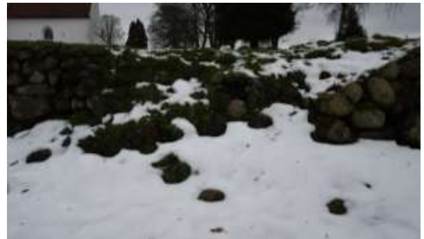
Foto 7. Udskredet parti på syddiget
