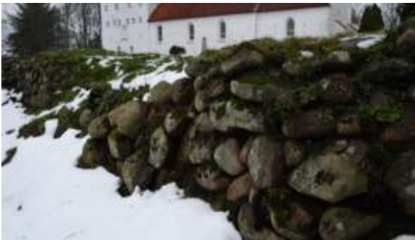
Foto 6. Udskredet parti på syddiget
