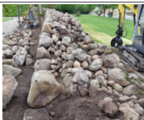
Digekerne med stenskellet.
