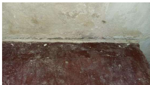
Forhøjet gulv ved alter
