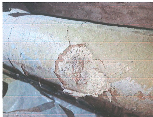
#4 Brud på asbestholdig rørisolering.
