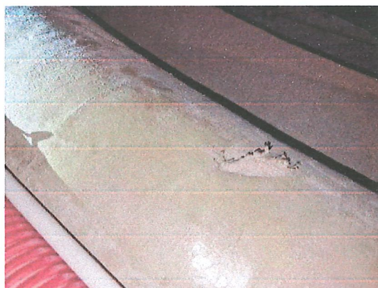
#3 Brud på asbestholdig rørisolering.
