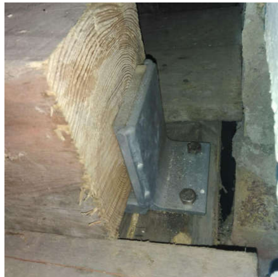
Endestop samme kirke. Vibrationsdæpende sylomer mellem metal og bjælke.
