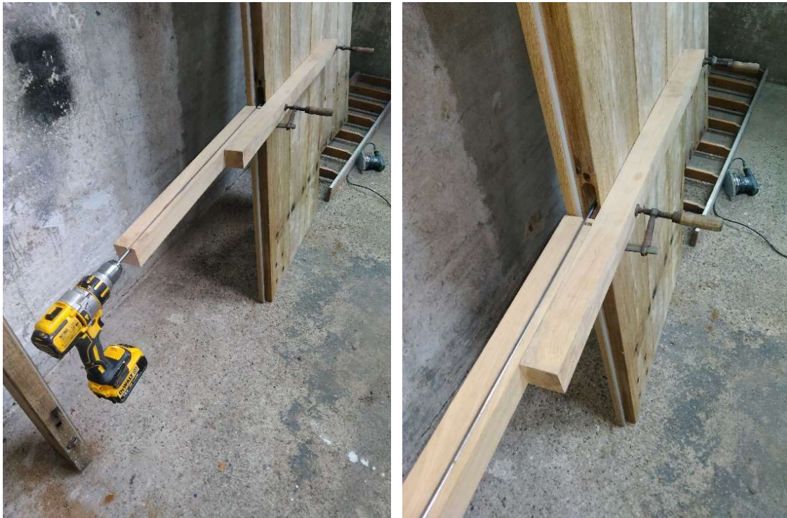
Kabelføring i kirkedør, eksempel fra anden kirke.
