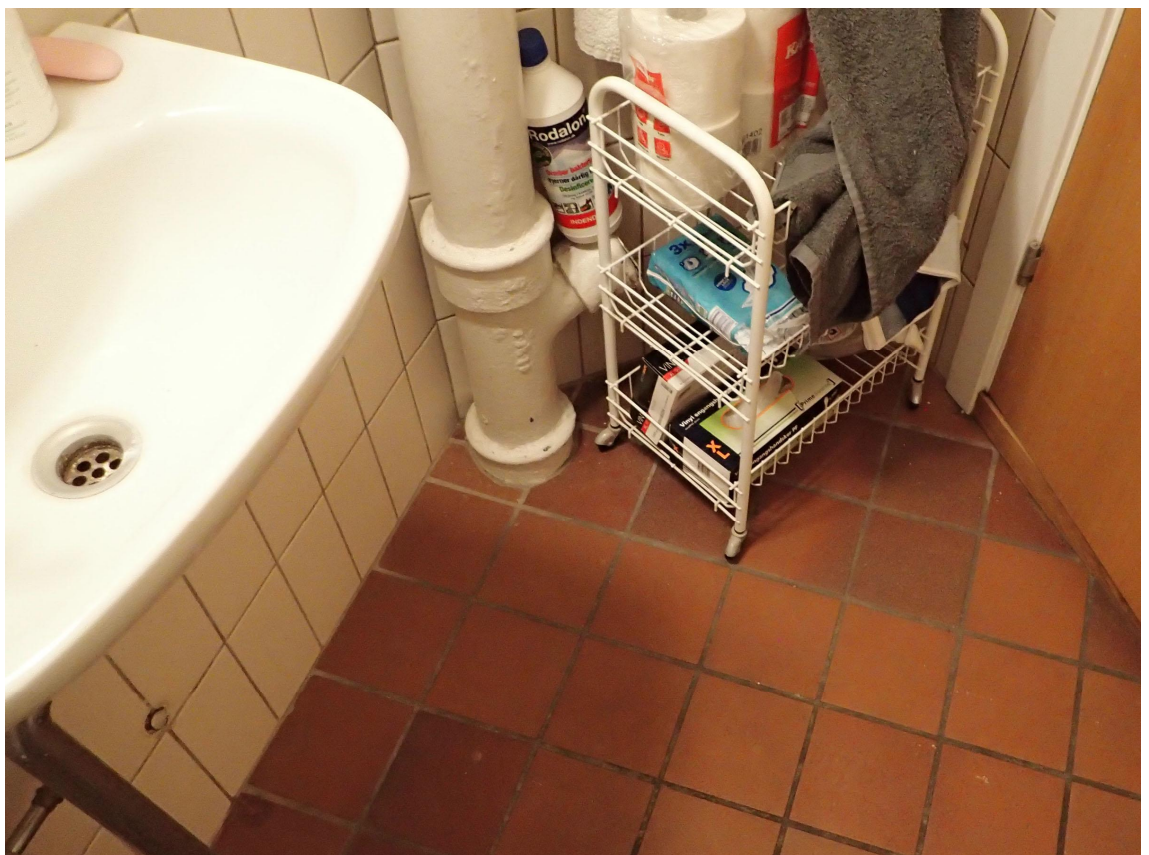
Foto 6 – Toilet, nærbillede af faldstamme hvor toilet ønskes tilkoblet
