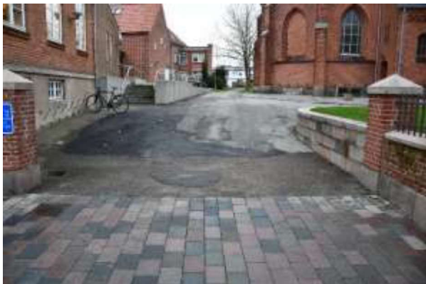
Foto 5. Indkørslen til kirkeparken. Asfaltlaget er lappet
