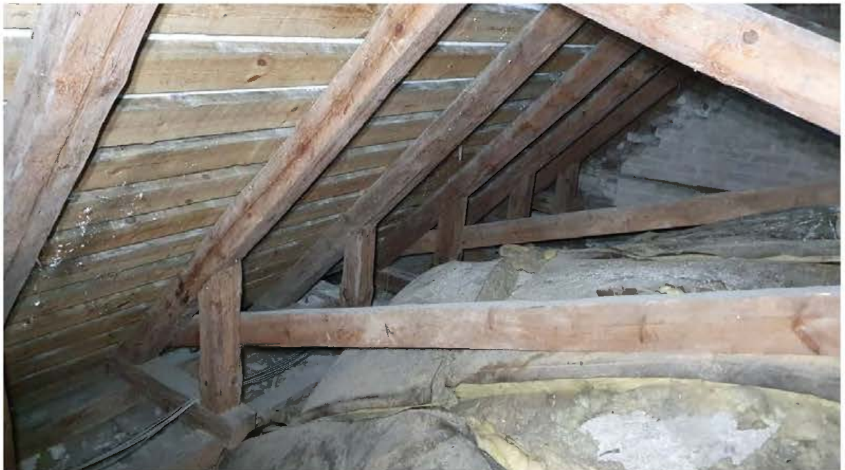
Isoleringen over koret. Isoleringen bør gås efter, og måtterne rettes til.
