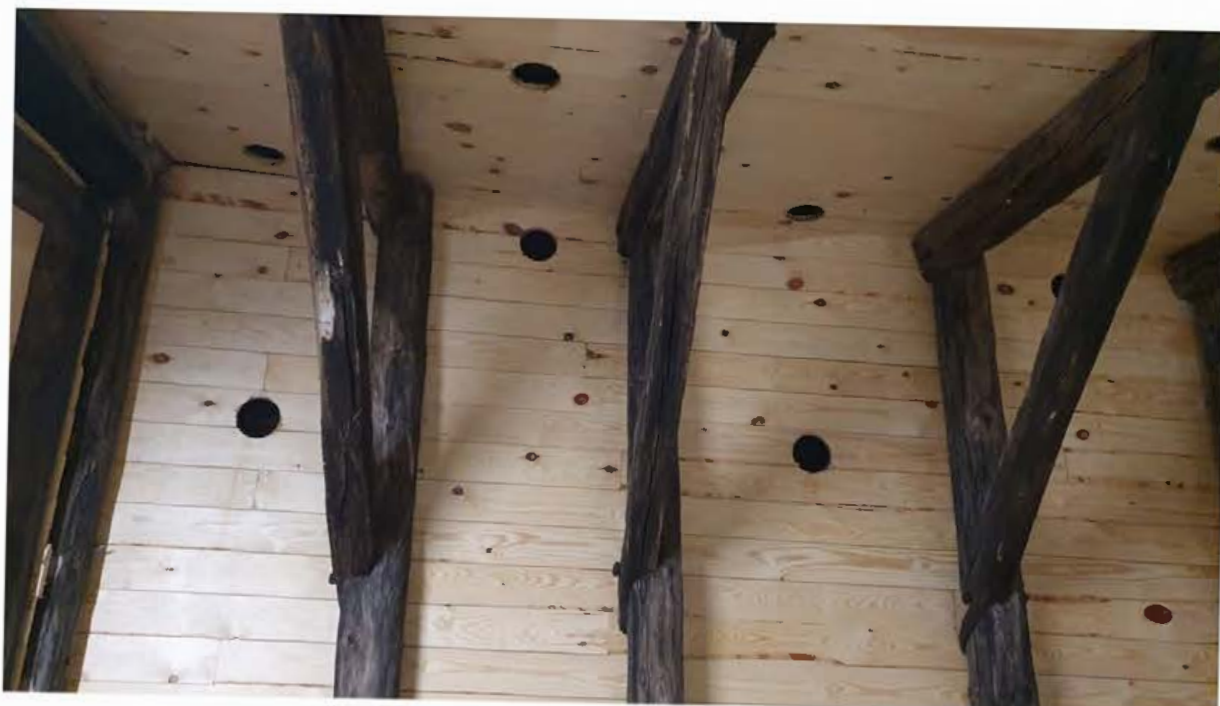
Det relativt nye tegltag over forhal og skib har undertag af brædder og tagpap. Der er ventilationshuller ved tagfod og i kip og tagrummet fremstår velventileret.
