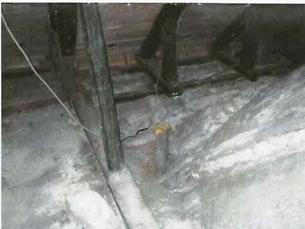
Sladrehuller i hvælvene er tilstoppede, så der er ingen forbindelse ned til kirkerummet
