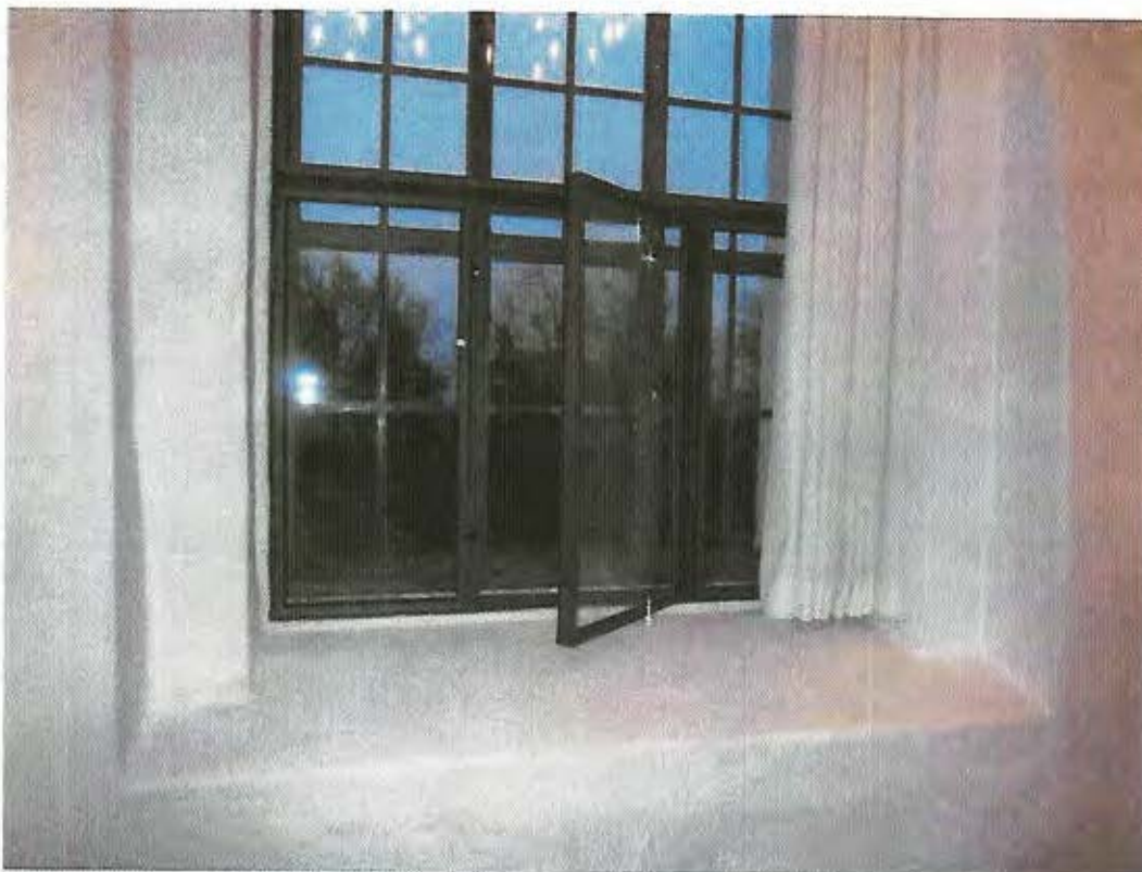
Forsatsruder begrænser den naturlige ventilation gennem utætheder. Oplukkeligt felt i forsatsrude giver dog mulighed for udluftning
