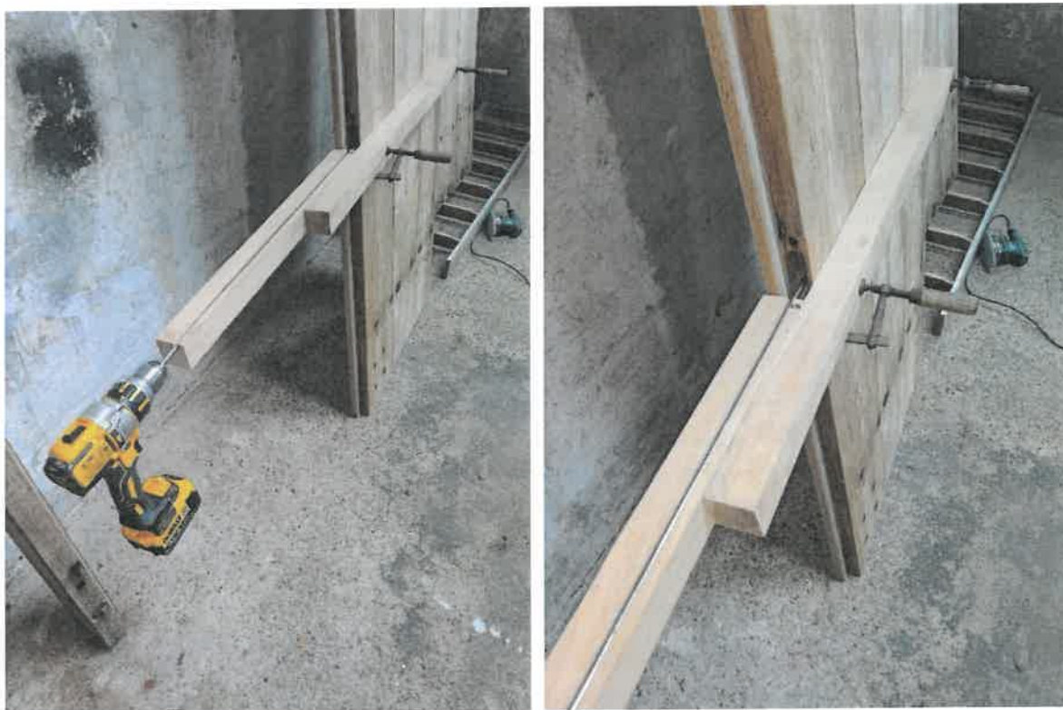
Kabelføring i kirkedør, eksempel fra anden kirke.
