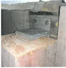
Endestop med vibrationsdæmpende søjler mellem metal og bjælke. (Dog åben model, fra en anden kirke)
