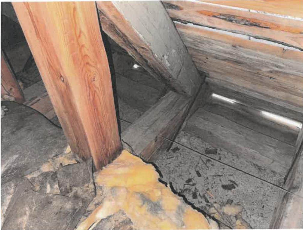
Koret. Her ses det tydeligt på brædderne at der er utætheder. Isolering ikke afsluttet ordentligt.
