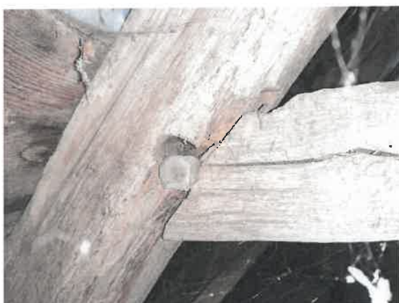
Ødelagt hanebåndssamling i kor
