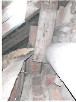
Ved 3 bindbjælker er der lagt nye bjælker ind, uden at være samlet med eksisterende
