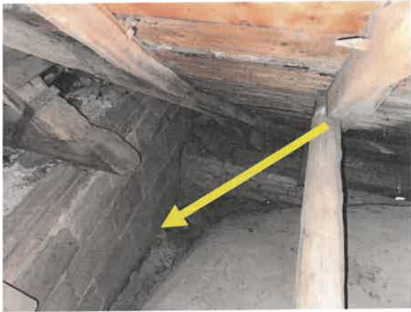
Revne mellem hvælv og kor.
