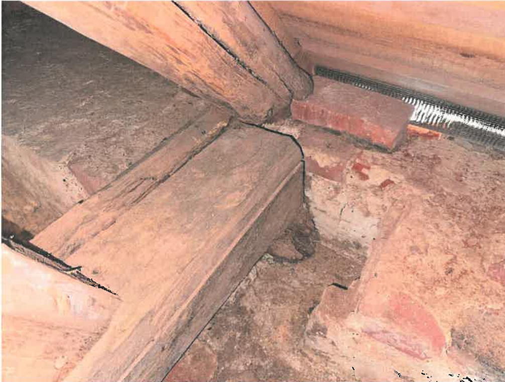
Tårnet. (Som ikke er med i projektet) ingen forbindelse/samling mellem bindbjælke og spær 3-4 steder.
