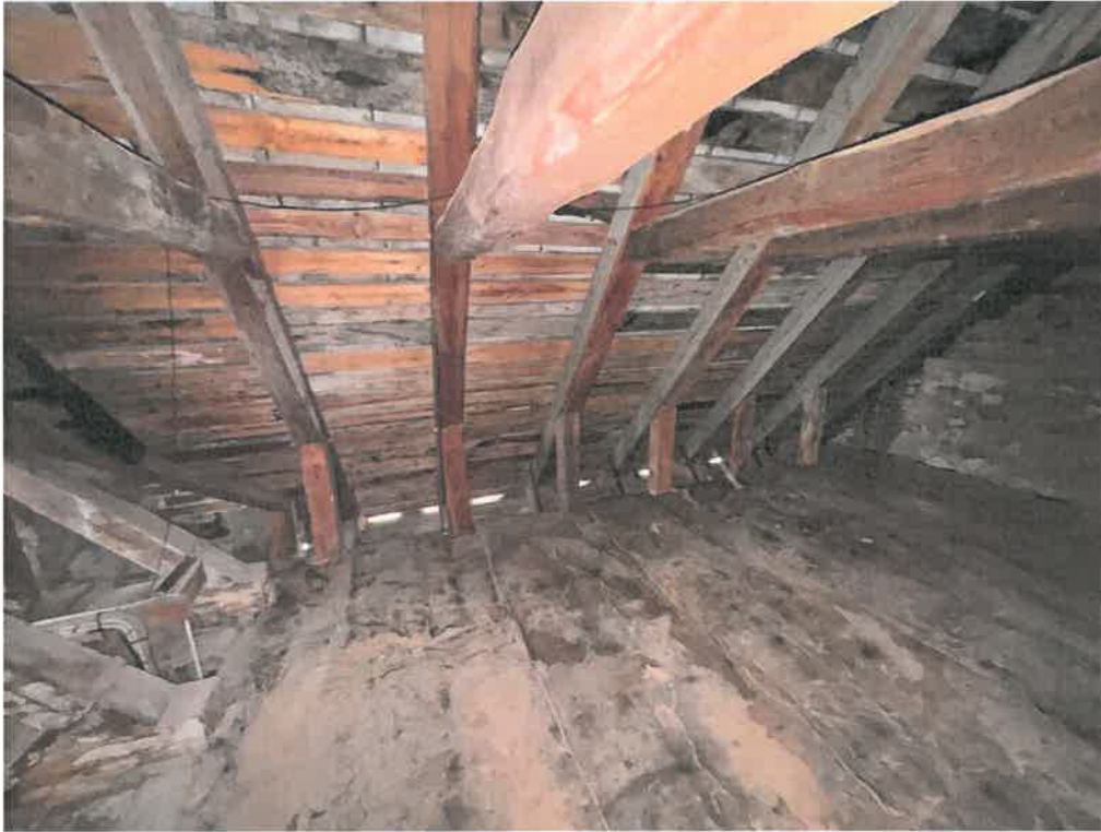
Sideskibet. Her ses det tydeligt på brædderne at der er utætheder, men konstruktionen er i rimelig stand. Isolering ikke afsluttet ordentligt.
