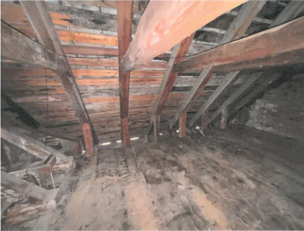
Sideskibet. Det tydeligt på brædderne at der er utætheder, men konstruktionen er i rimelig stand. Isolering ikke afsluttet ordentligt.
