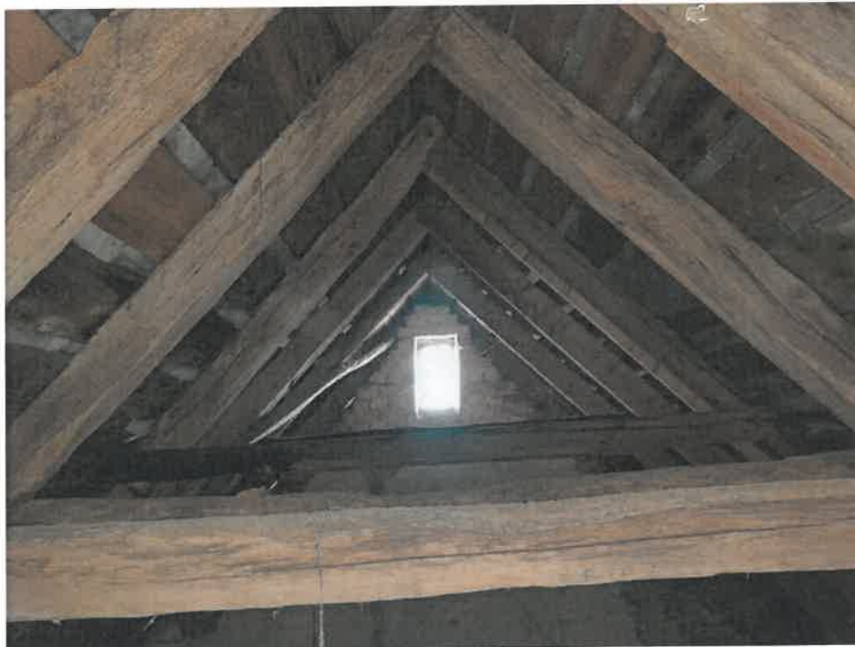
Tagkonstruktion i kor er angrebet af borebiller.
