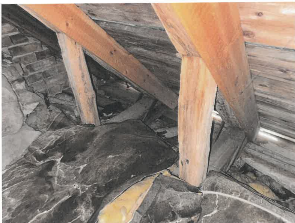
Våbenhuset. Isolering ikke afsluttet ordentligt.
