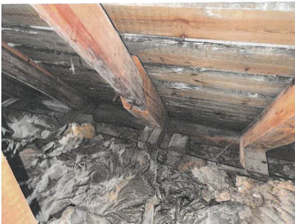
Våbenhuset. Det ses tydeligt på brædderne at der er utætheder og konstruktionen er istandsat men arbejdet ikke udført ordentligt. Isoleringen ligger dårligt. Flere bindbjælker er lagt ind mellem eksisterende.
