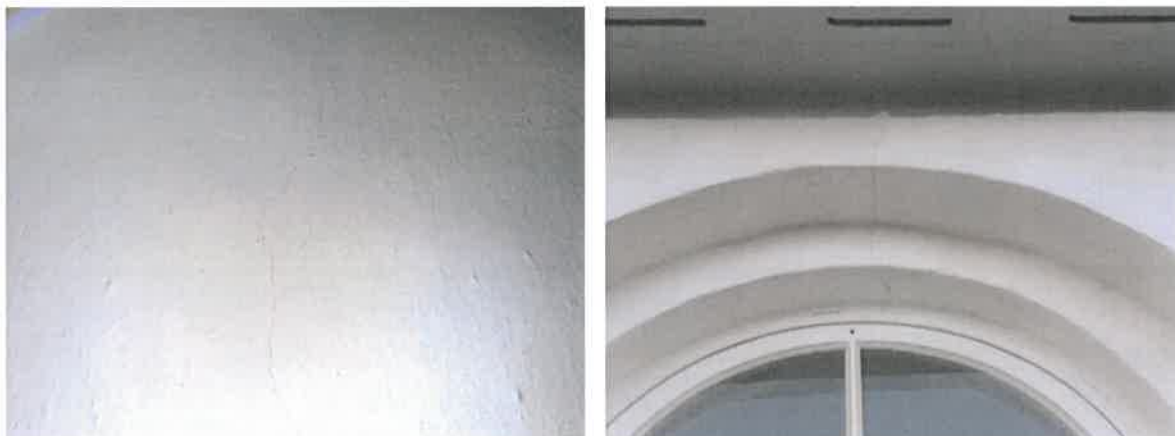
Revne i kor ved tilstødende udvendig sakristivæg. Udvendig revne over vindue
