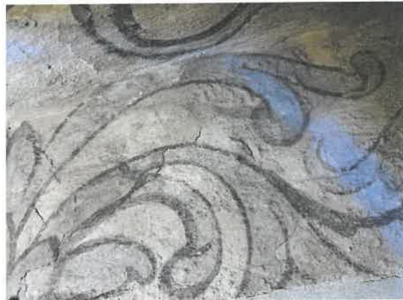
Revner i hvælv.
