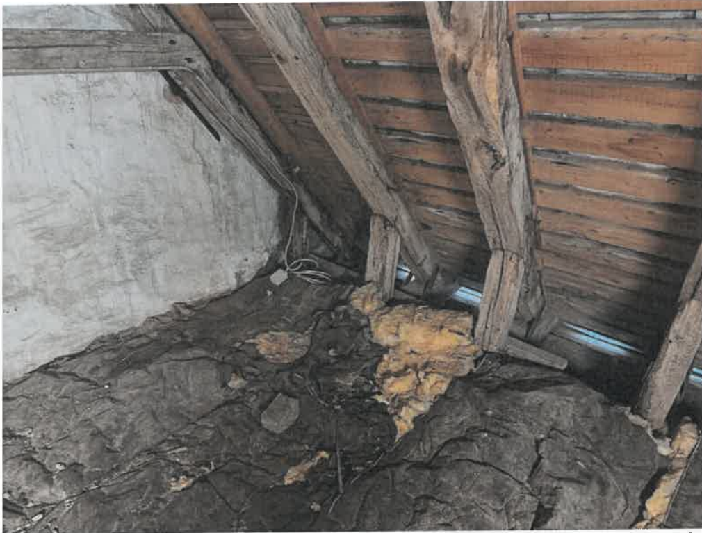
Skibets nordside. 1 spær er meget tyndt og nedbrudt. Isoleringen er meget nedtrådt. Isolering ikke afsluttet ordentligt.
