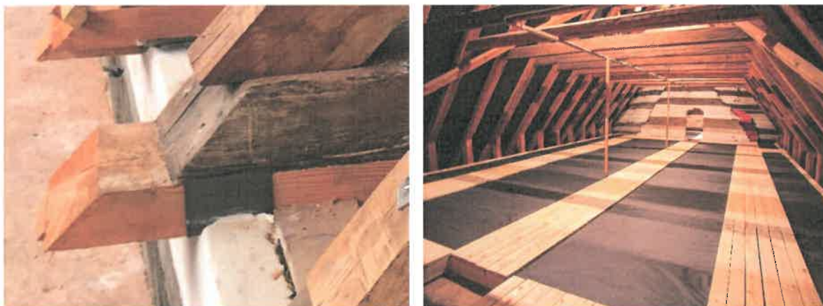
Bindbjælke udlust ved sugfjæl. Ny isolering og gangbroer (Billeder fra en anden kirke)
