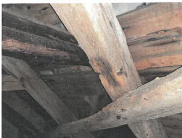
Hanebånd ikke monteret korrekt i kor
