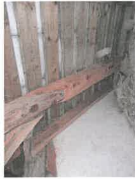
Eksisterende udlusning ikke udført korrekt
