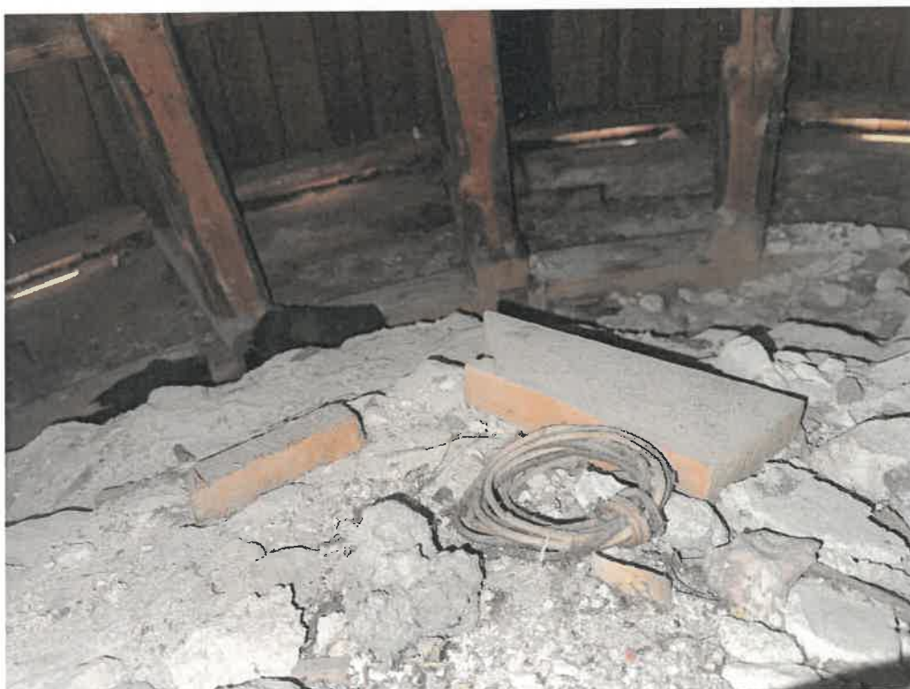
Apsis. Tømmer ser ud til at være i god stand. Der trænger til en gang rengøring. Men det er et svært tilgængeligt rum.
