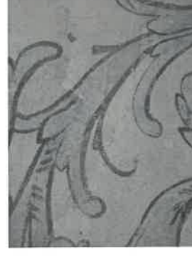
Revner i hvælv
