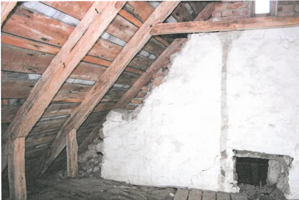
Apsis. Hullet ud til apsis. Der mangler gangbro når man skal kravle der ud ligger man i isoleringen. Der er et jernrør til el som også delvis blokere hullet.
