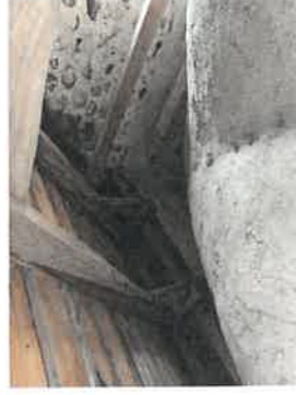
Eksisterende udlusning i spær
