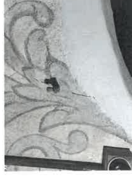
Revner i hvælv
