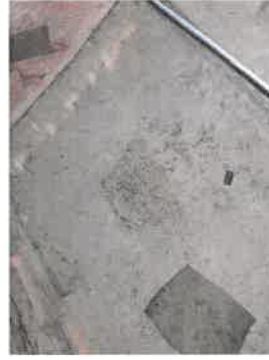
Murkrone med beton og borebille smuld
