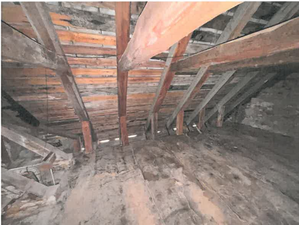
Sideskibet. Her ses det tydeligt på brædderne at der er utætheder, men konstruktionen er i rimelig stand. Isolering ikke afsluttet ordentligt.
