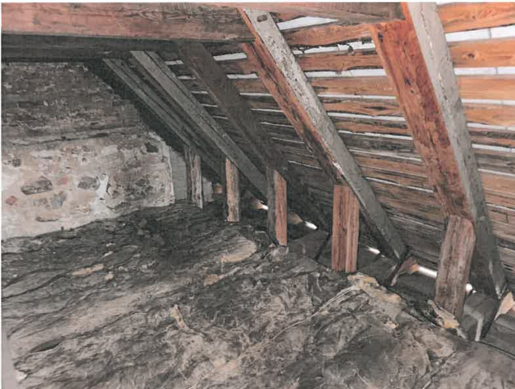
Sideskibet. Det ses det tydeligt på brædderne at der er utætheder, men konstruktionen er i rimelig stand. Isolering ikke afsluttet ordentligt.
