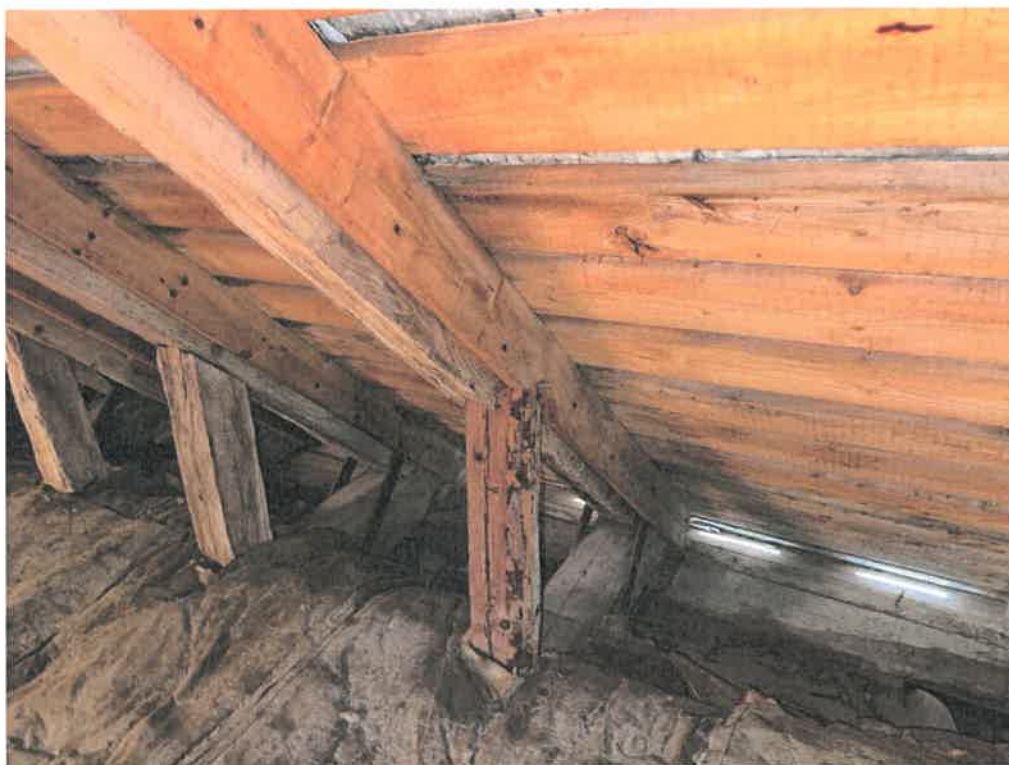
Skibets nordside. Gammel isolering og lasker på næsten alle spær. Konstruktionen ser ud til at være i god stand, ud over at spærerne buer meget. Isolering ikke afsluttet ordentligt.
