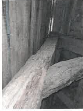
Spær meget nedbrudt af borebiller
