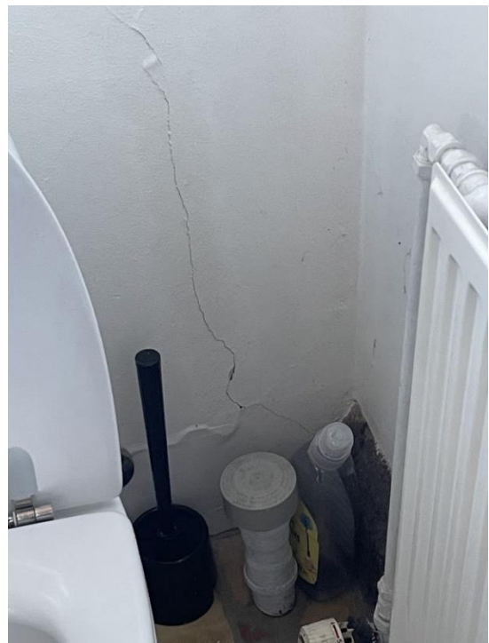
Revner og afskalning på toilet
