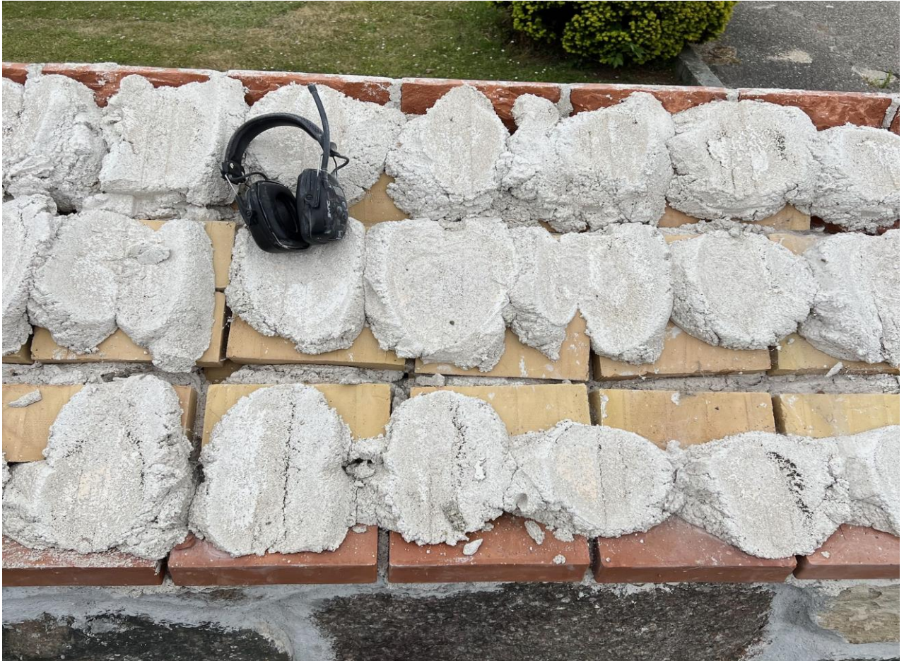
Før istandsættelse - ubrugelige tagsten fjernet - mur mod øst - manglende læggemørtel.
