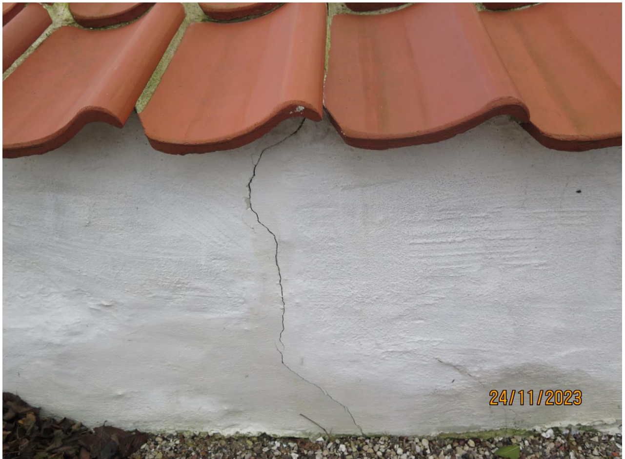
Revne i mur efter fjernelse af beplantning
