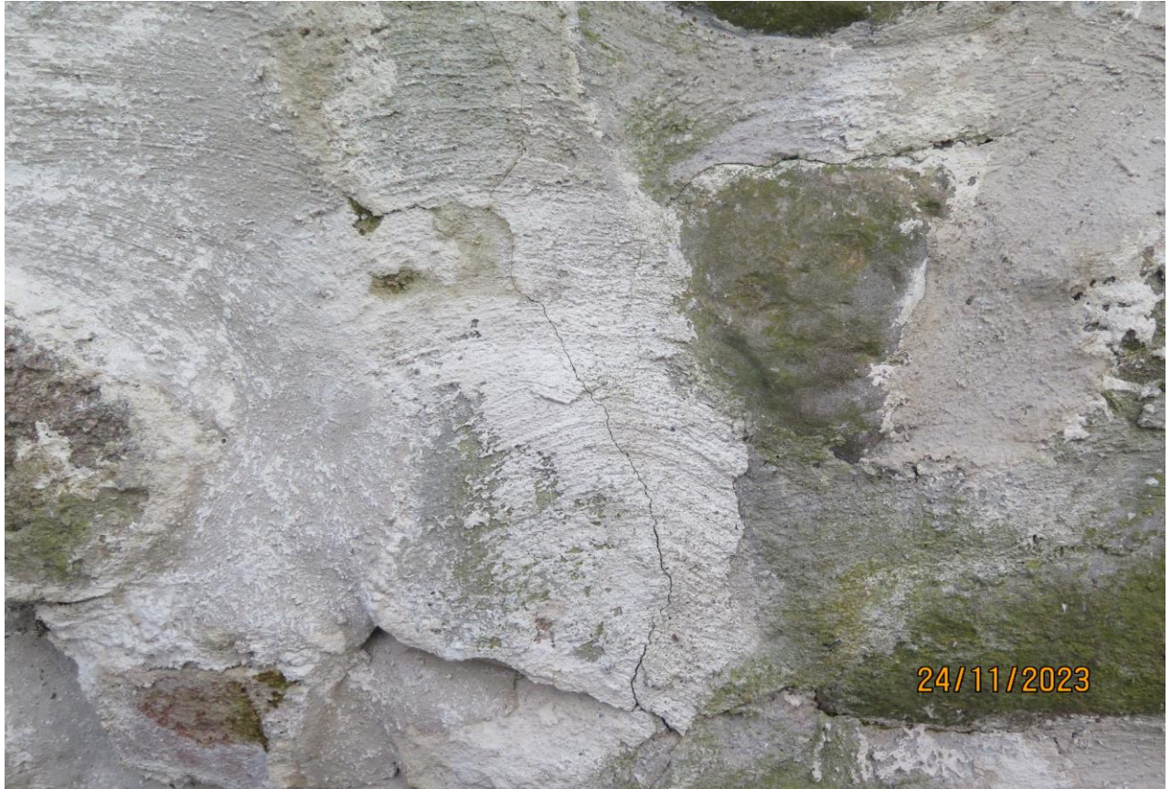
Revne i mur efter fjernelse af beplantning
