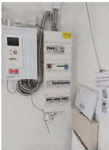
Fig 1. Kablet kobles til eksisterende el-tavle og eksisterende tidsstyring i kirkegårdens teknikrum. El-tavlen skal ikke udvides.
