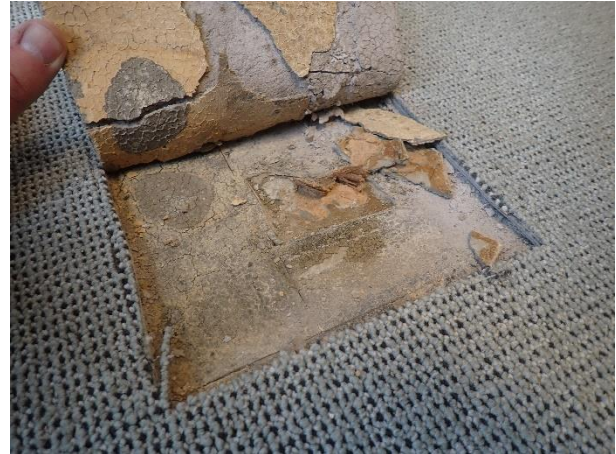
Foto 6: Oplukning i deformeret gulvbelægning
