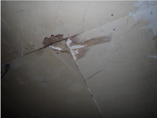
Foto 5: Skjolder og misfarvninger på gipsloft
