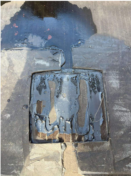
Foto 11. Brudflade efter prøve. Brud ses i/ved tagpappens overflade og vedhæftningslag.
