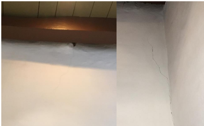
Eksempel på revner i kor
