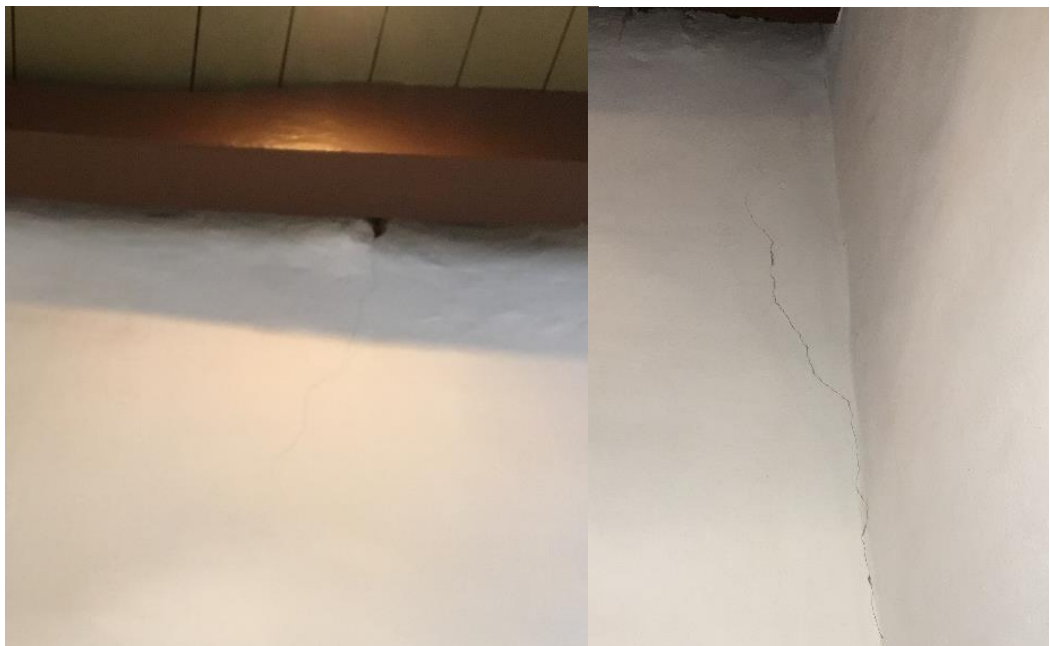
Eksempel på revner i kor
