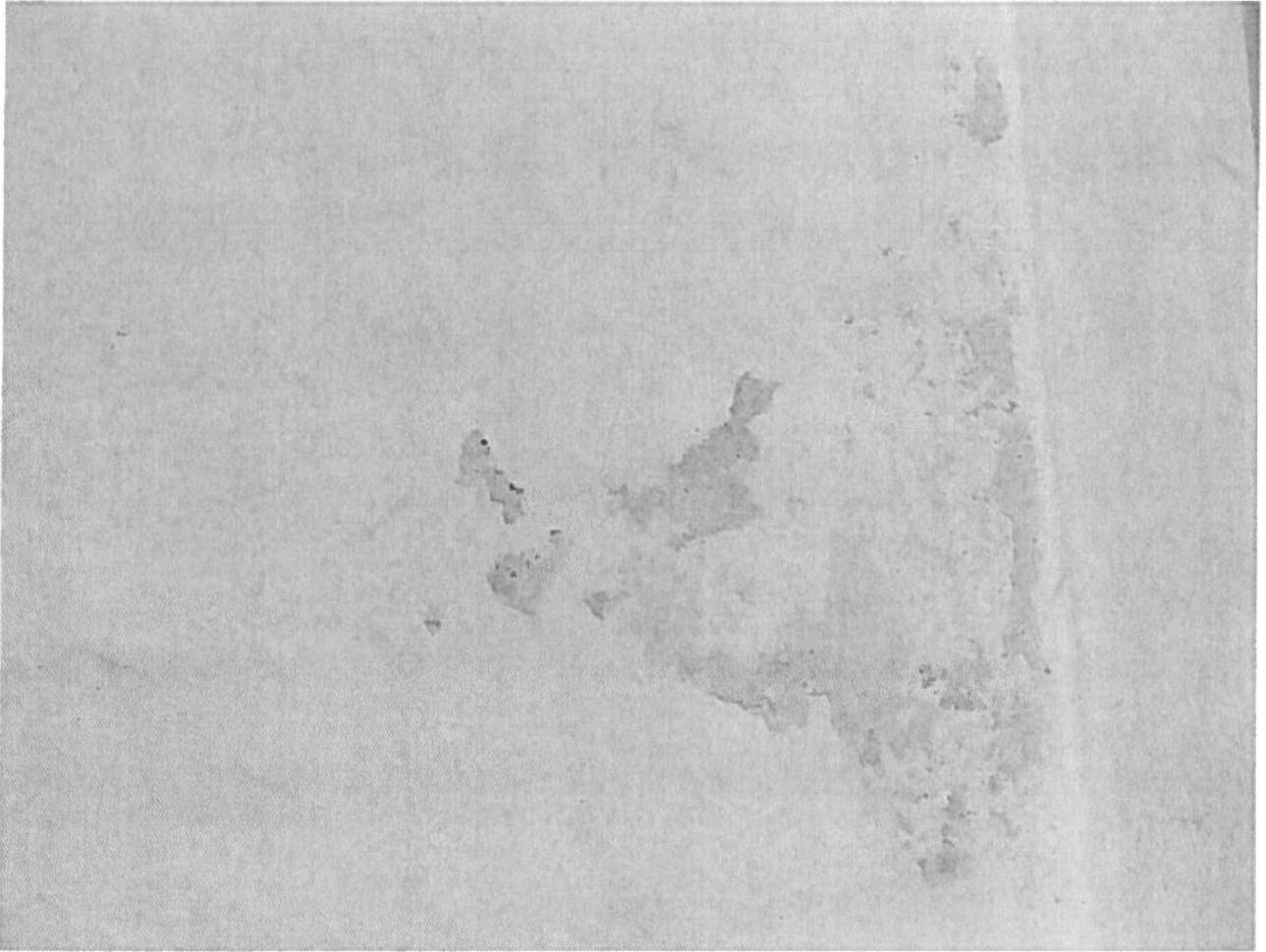
Albæk Kirke, vestforlængelse saltskader.
